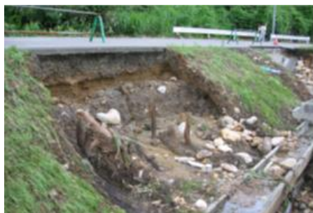
道路法面の崩壊状況
