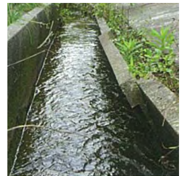
側壁の倒壊（側溝）
