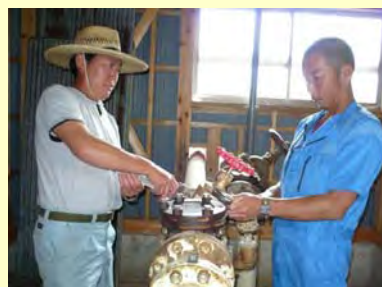
ポンプの点検状況
