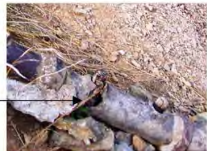
古い樋管（陶製）の破損
