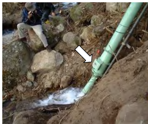
簡易な発電機（図の矢印）
