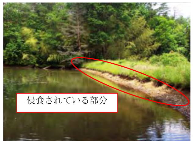
侵食が生じているため池堤体
