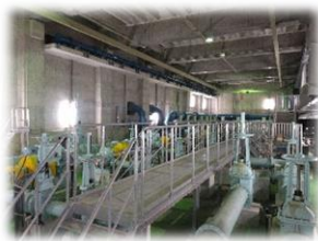
送水ポンプ棟照明
